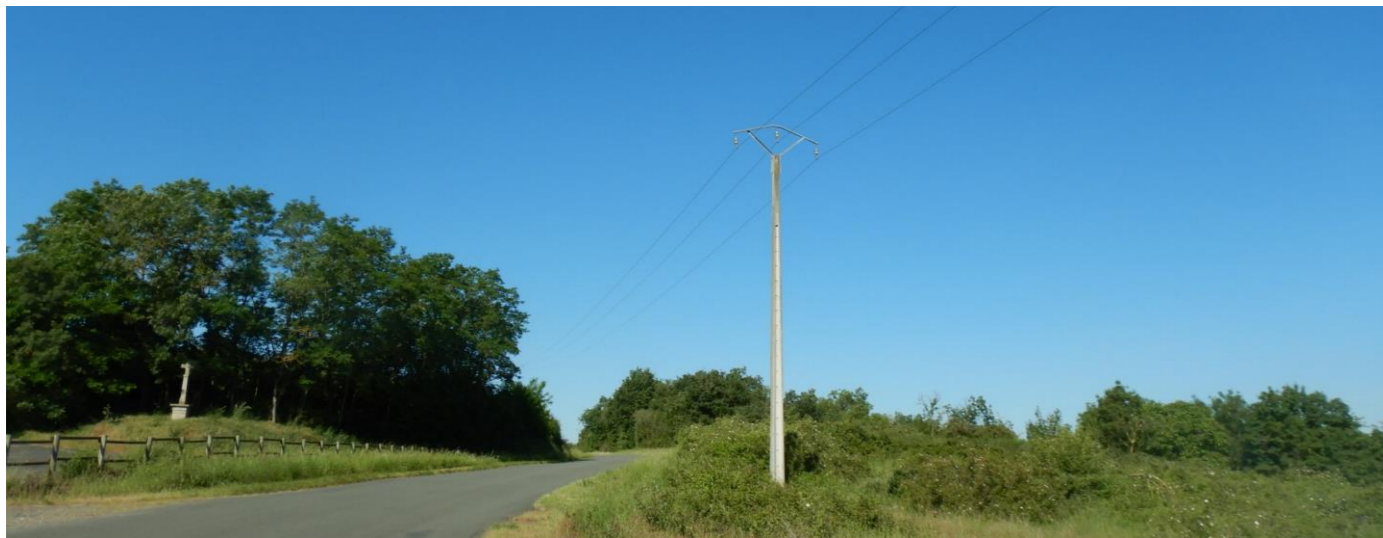
Photo 65 : ligne électrique le long de la RD135 au sud de l'aire d'étude immédiate
